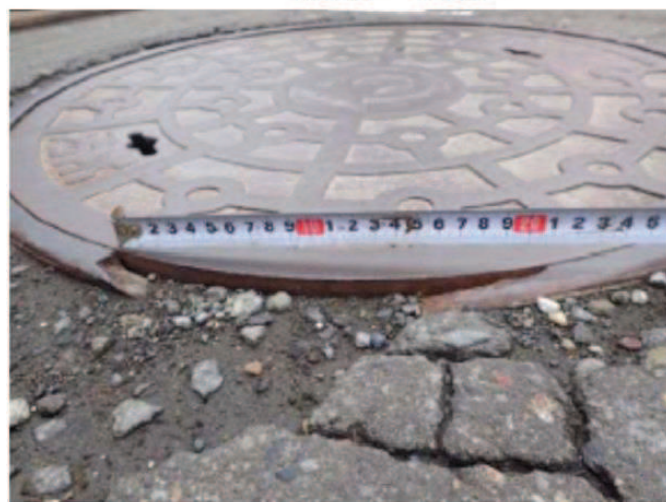
マンホール蓋枠破損・蓋摩耗状況
