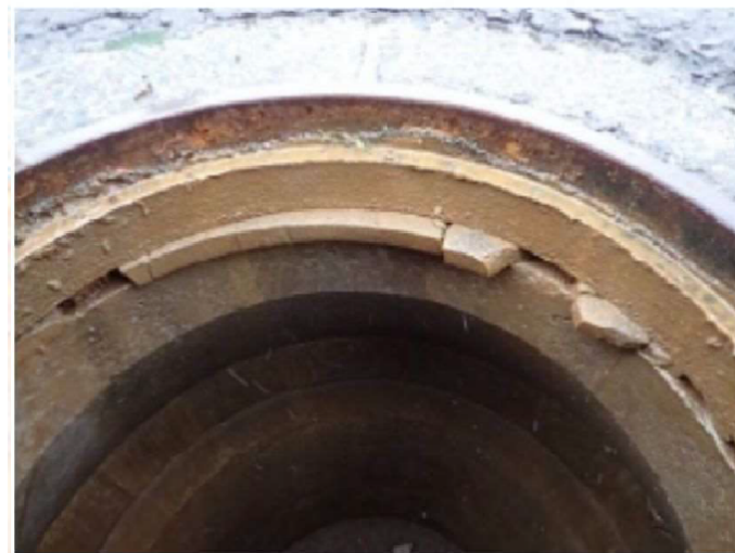
マンホール目地破損状況
