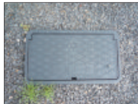
水道メーター
