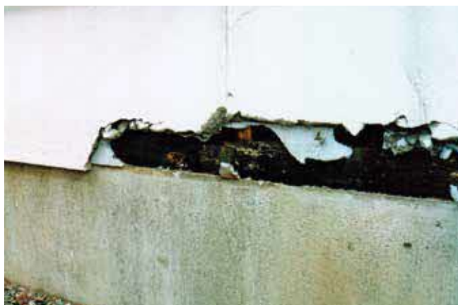
土台の腐食。夏場の床下換気により回避できます。
