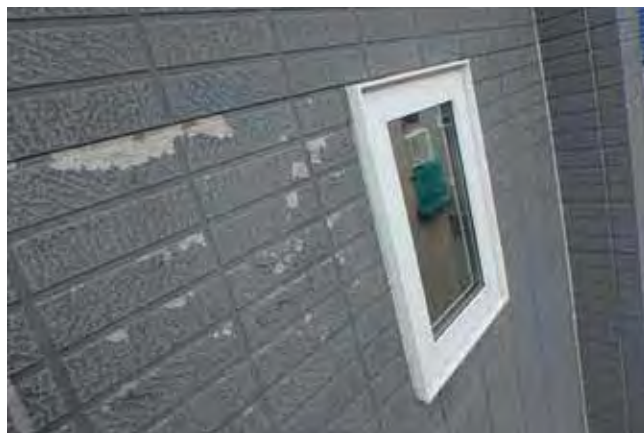
凍害が始まっているサイディング。
