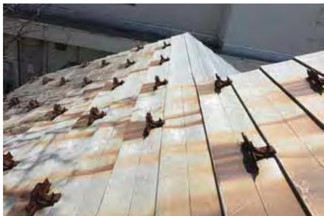
屋根腐食に注意。
