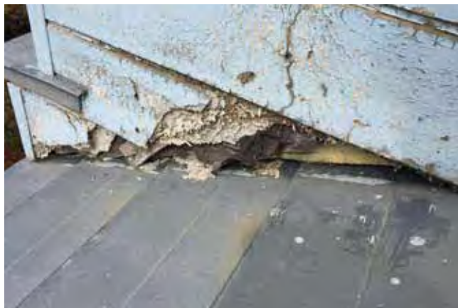
雪に接する場所は外壁材の劣化が進みやすい。
