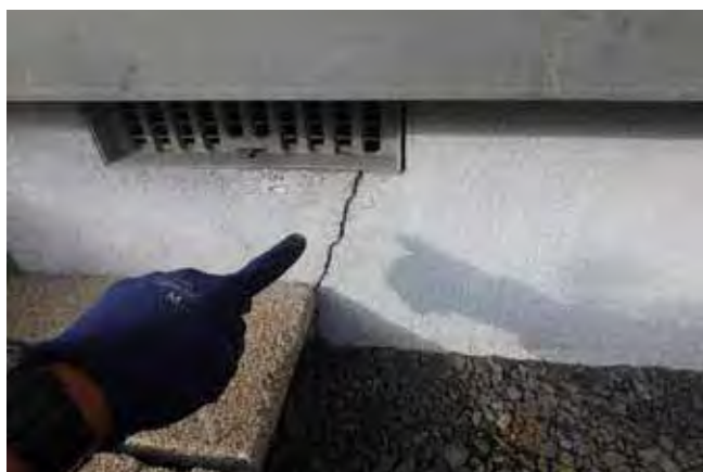
基礎のひび割れ。
