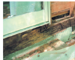
土台:壁を重ね張りしていたことで、壁の中の水分が逃げず、土台に溜まってしまったため土台も腐食していた
