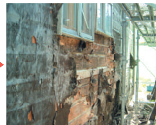
外壁(下地):腐食がひどく指で触るだけで、ぼろぼろ落ちる状態
