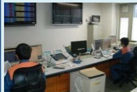
深川消防署通信指令室
