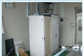
無線回線制御装置
