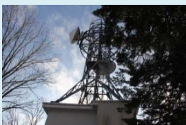
防災行政無線常盤中継所
