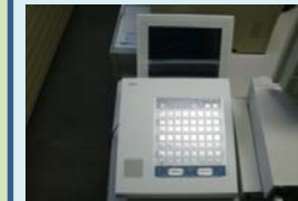
サイレン吹鳴制御装置
