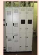
基地局無線機装置
