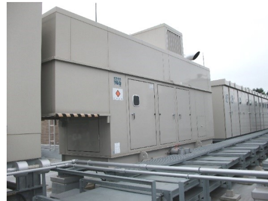
非常用自家発電設備の例
