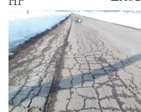
ひび割れが発生した道路
