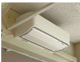
小中学校に整備した空調設備
